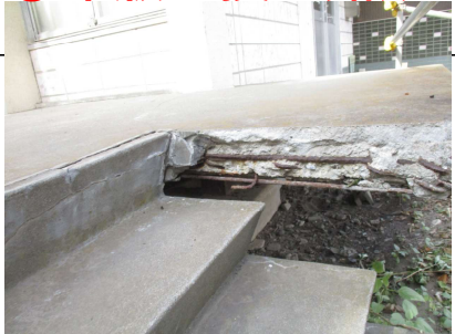
⑩床版欠損・露筋
