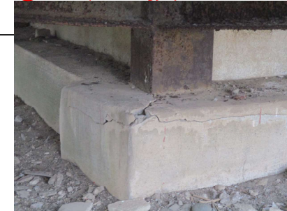
⑪基礎欠損
