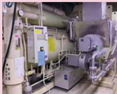
役場地下室の機器
