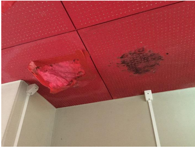
天井の雨漏り
