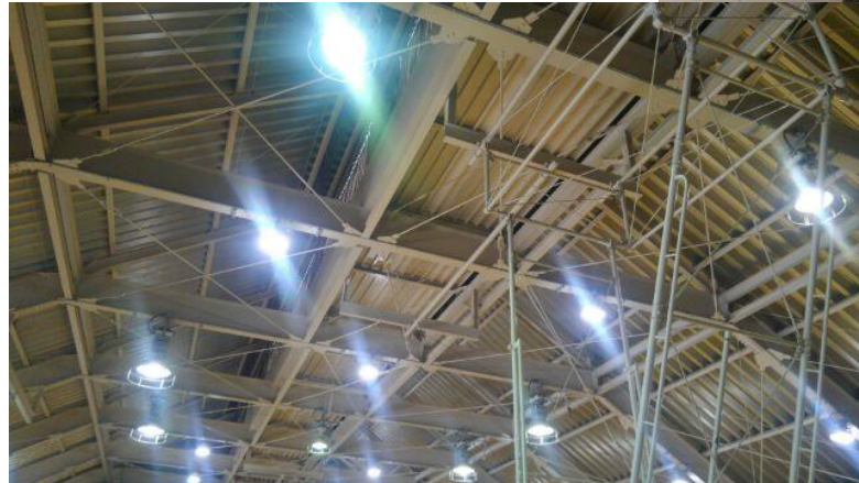
体育館屋根の雨漏り
