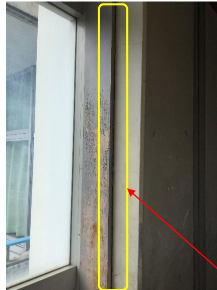
渡り廊下の接続部のひび割れ。
