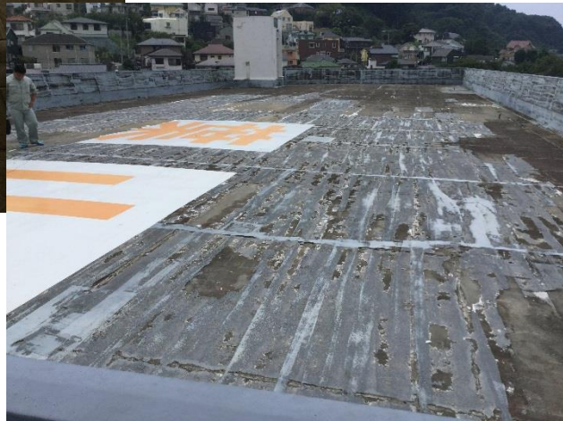
補修が必要な屋上
