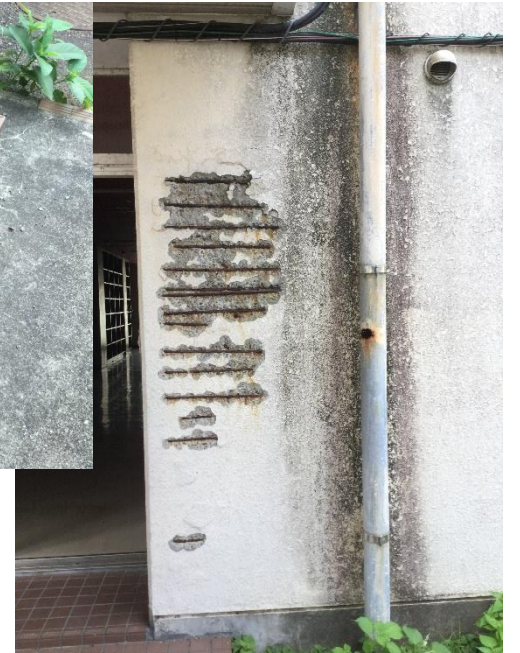
牛乳搬入場所の段差、ひび割れ、剥き出しの鉄筋
