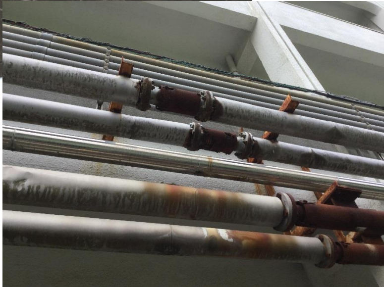
屋上の補修痕や不要な腐食した配管
