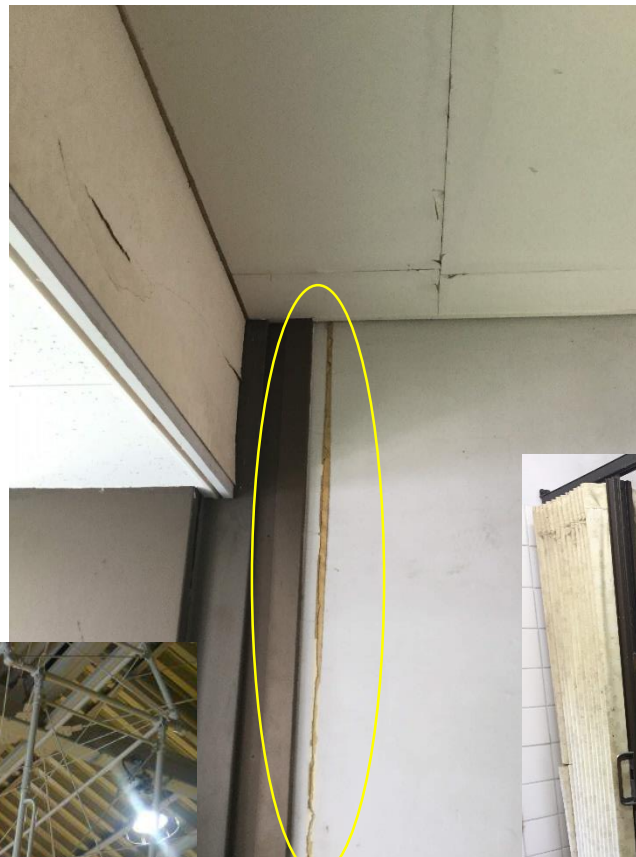
渡り廊下 接続部分ひび割れ 崩壊の懸念も？
