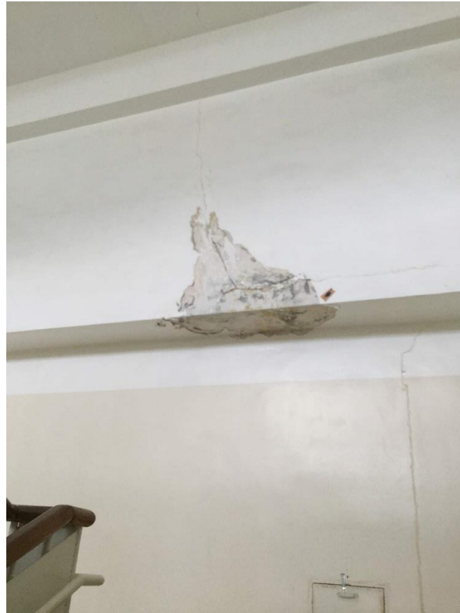
壁のひび割れ
