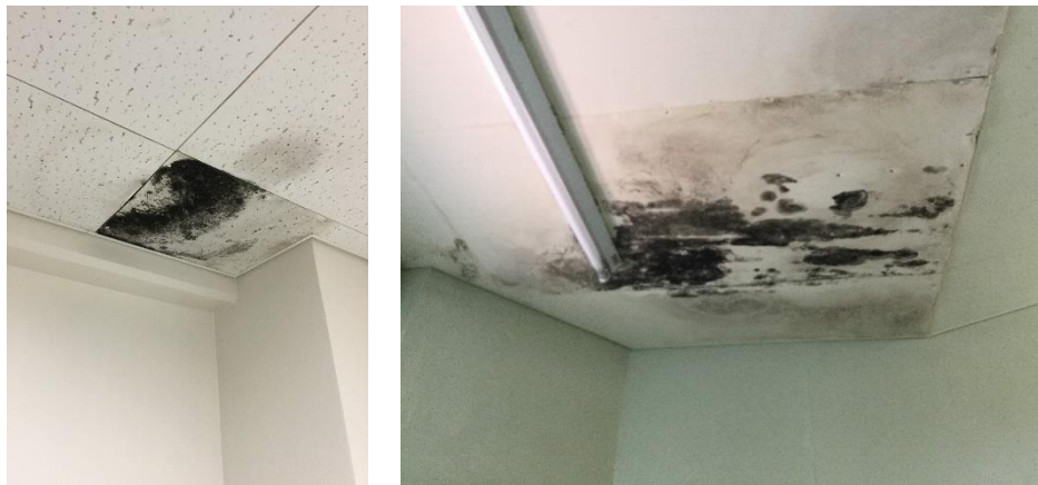
廊下天井の雨漏り痕
