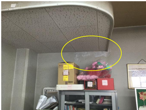
図書室雨漏り・ドアの穴
