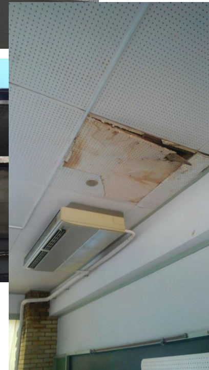
校舎外壁クラック・ひび割れ・傷んだ教室の天井
