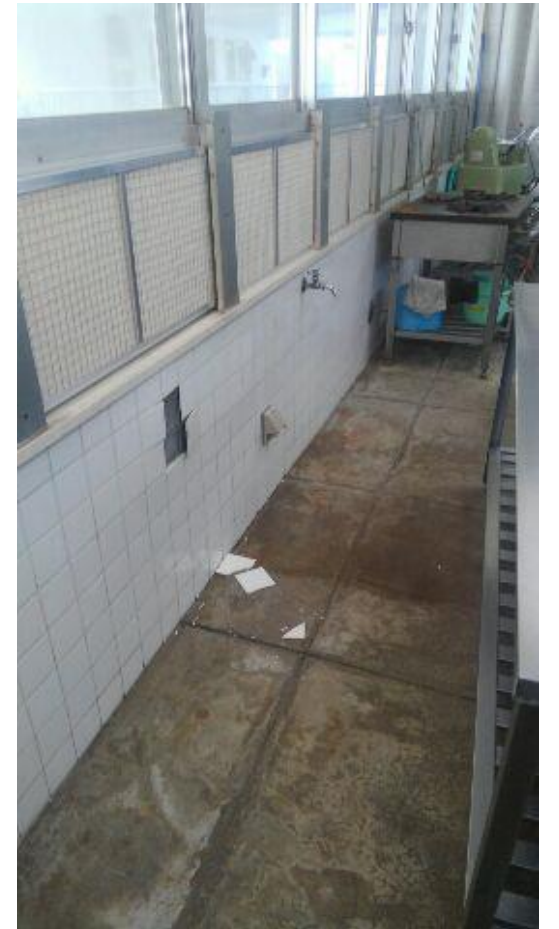
給食室のタイル剥がれ、錆びた回転釜
