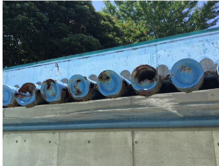
プール屋根の腐食
