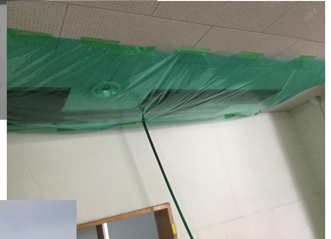
天井内部の配管から水漏れ
