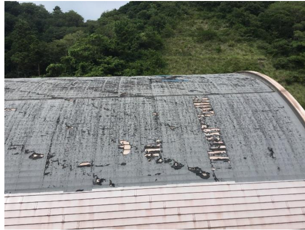
体育館屋根の傷み
