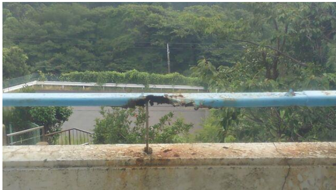
ベランダ手摺の状態
