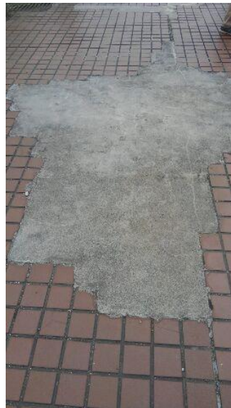
屋上タイルの補修痕
