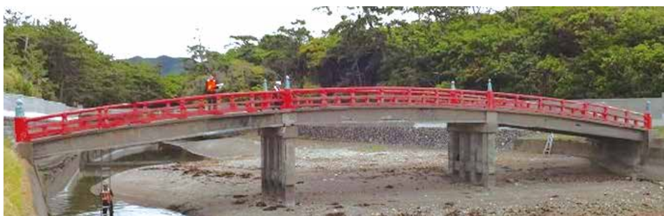
改修を待つ臨御橋
