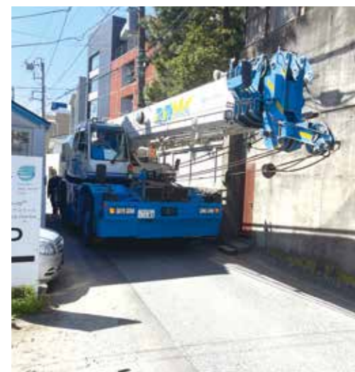
逆走する工事車両
