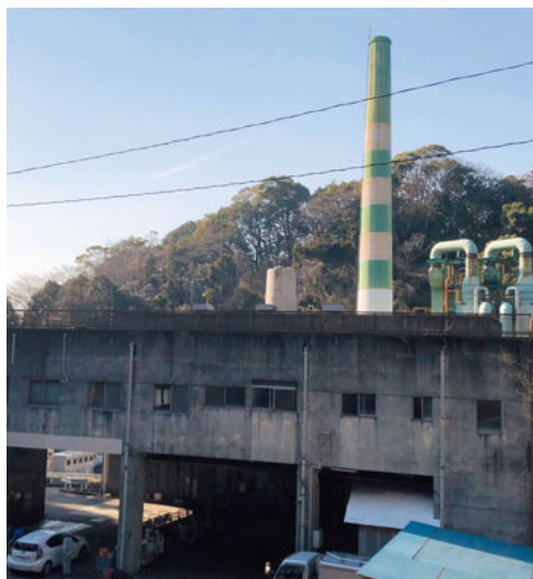
老朽化したクリーンセンター
