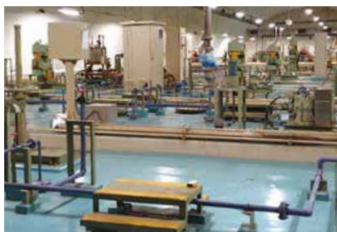
葉山浄化センター
