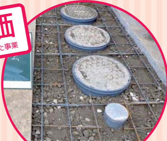
合併処理浄化槽補助 38基の転換
