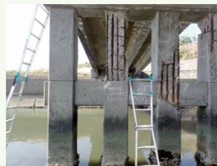
老朽化した橋桁
