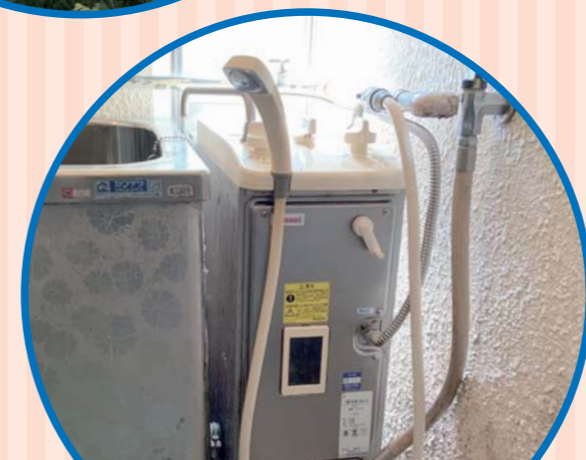
町営住宅の給湯機器 事故防止の観点からも更新を
