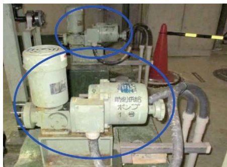
浄化センター更新箇所
