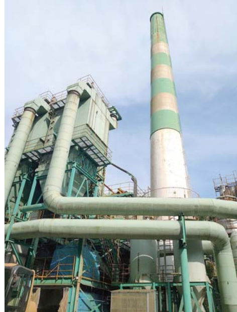
ごみ焼却施設
