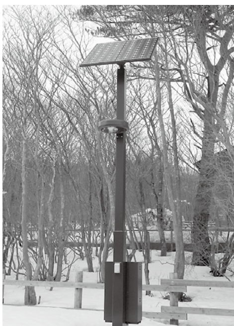
那須町のソーラー発電街路灯
