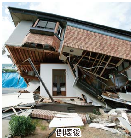
耐震シエルター内部
