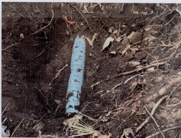
2018.11.30 残念ながら水道管でした
