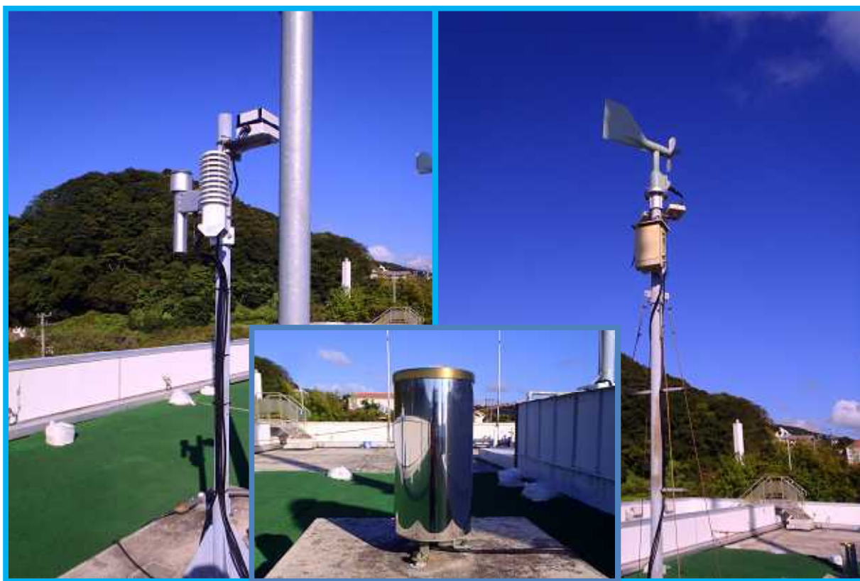
消防庁舎屋上の気象情報収集装置
