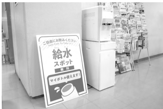
マイボトルを推進して町施設に給水機を設置
