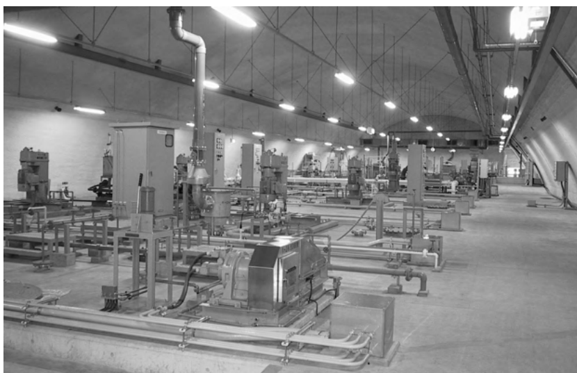
葉山浄化センター
