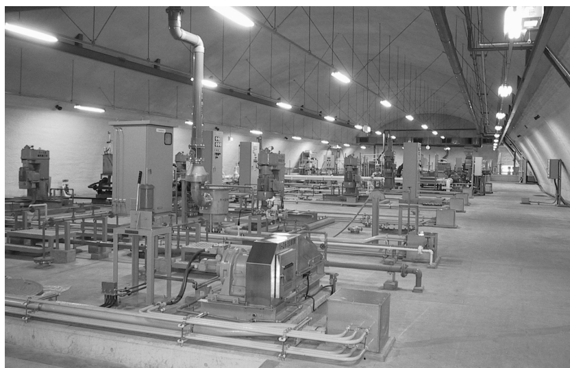
葉山浄化センター
