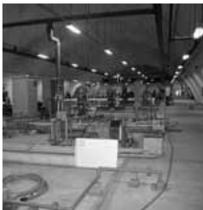
エアレーションタンク（上部）
