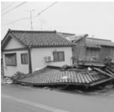
▲倒壊した建物。
