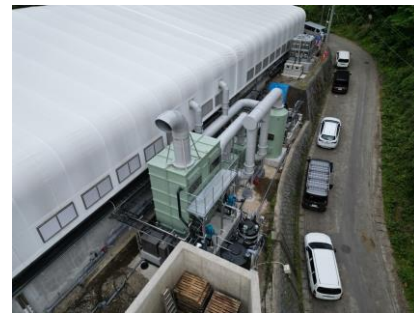
〔生ごみ資源化処理施設周辺設備状況〕
