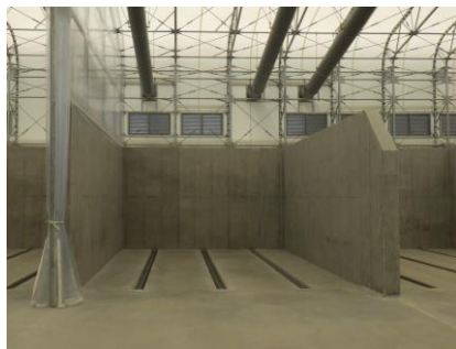
〔生ごみ資源化処理施設内部状況〕
