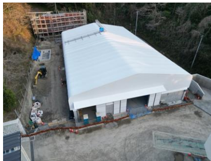
〔生ごみ資源化処理施設周辺設備状況〕
