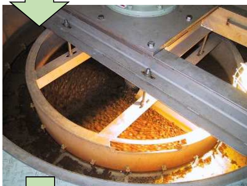
造粒濃縮設備
