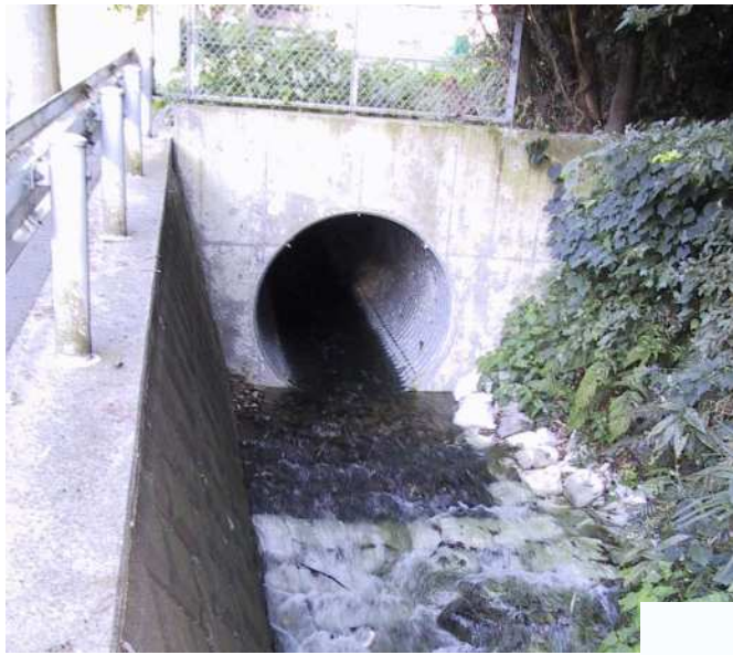
浄化センター放流口
