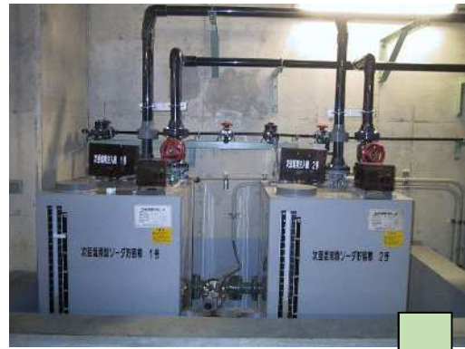
消毒設備 (次亜塩素酸ソーダ貯留槽)
