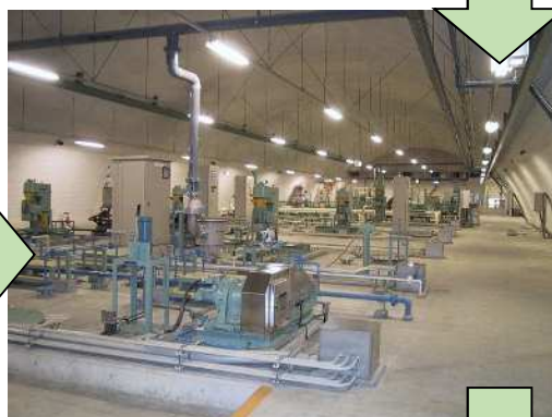
エアレーションタンク（上部）
