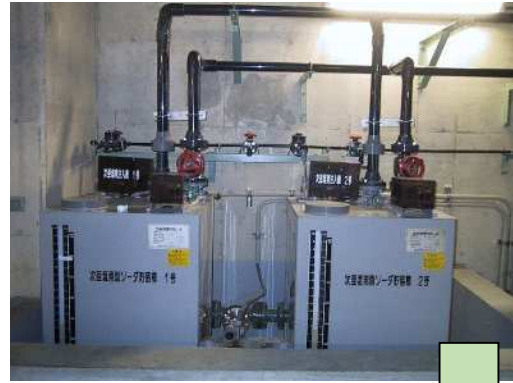
消毒設備 (次亜塩素酸ソーダ貯留槽)
