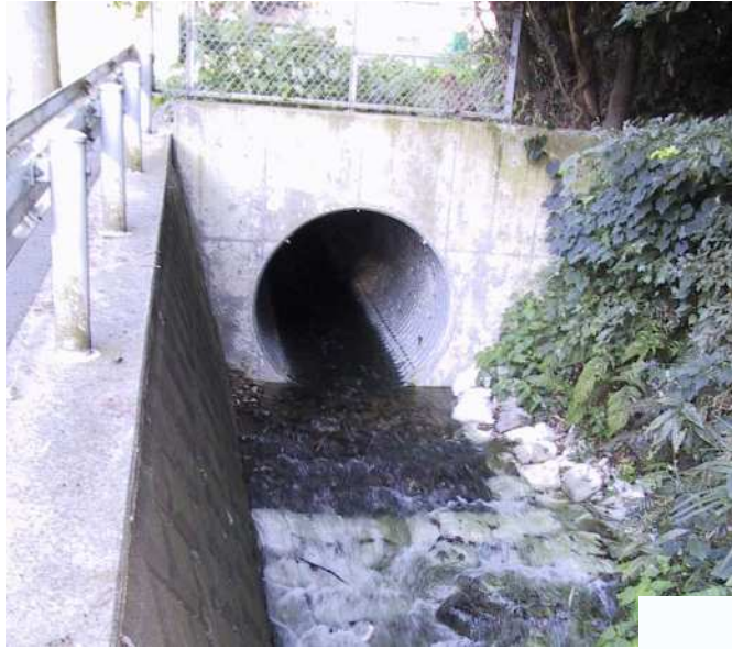
浄化センター放流口
