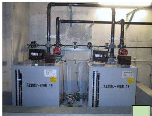
消毒設備 (次亜塩素酸ソーダ貯留槽)
