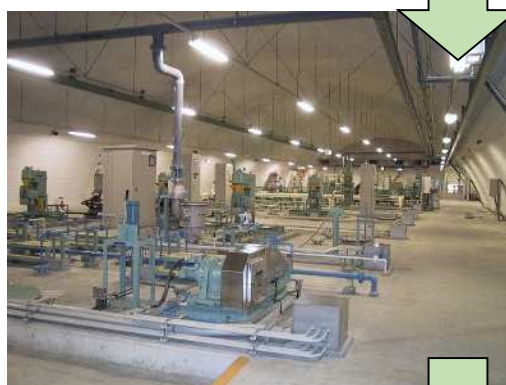
エアレーションタンク（上部）
