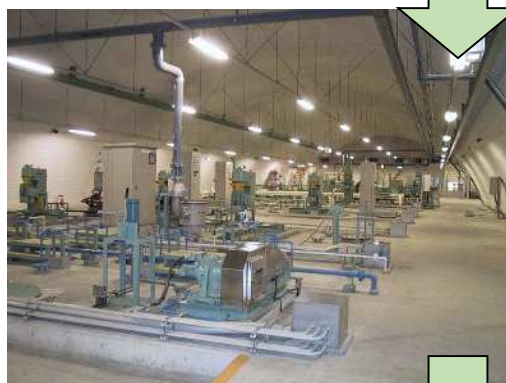
エアレーションタンク（上部）
