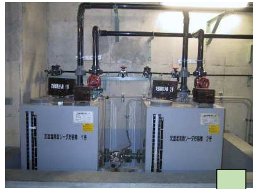
消毒設備 (次亜塩素酸ソーダ貯留槽)
