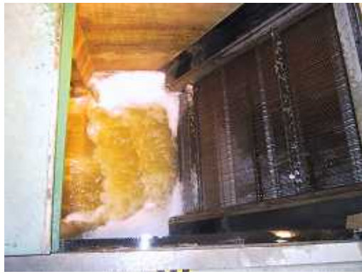
夾雑物除去設備
