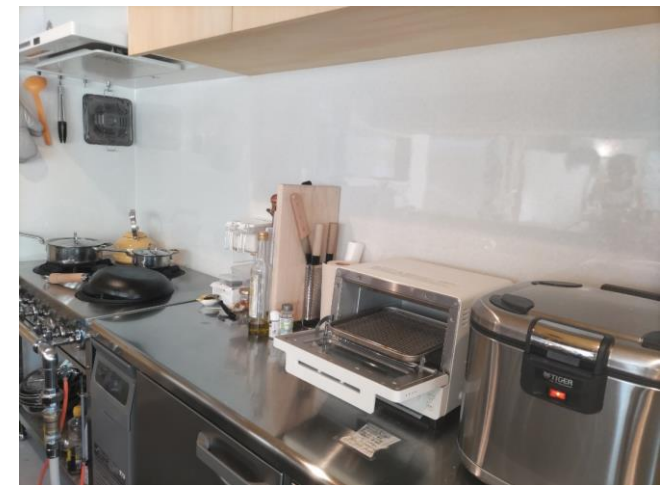
▲当店の厨房 左からガステーブル、オーブン、保温器 電子レンジは設置せず
