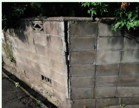
▲ 危険なブロック塀 (写真はイメージ)
