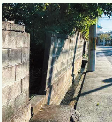
▲ 傾いたブロック塀は倒壊する危険があります(写真はイメージです)
