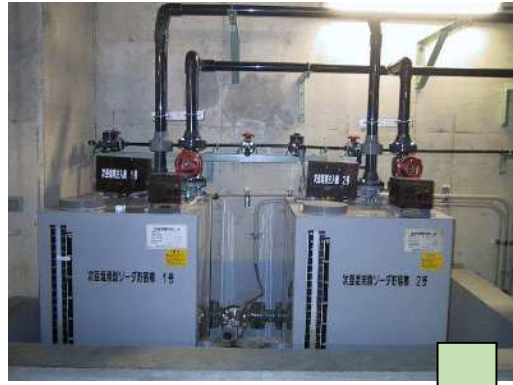
消毒設備 (次亜塩素酸ソーダ貯留槽)
