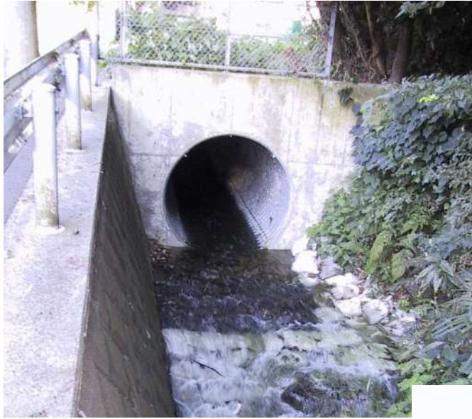
浄化センター放流口
